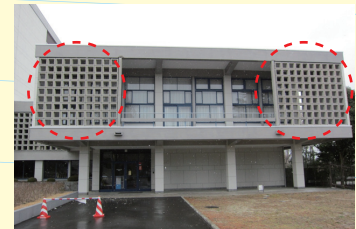
ブロック破損による倒壊の危険性がある松下会館
